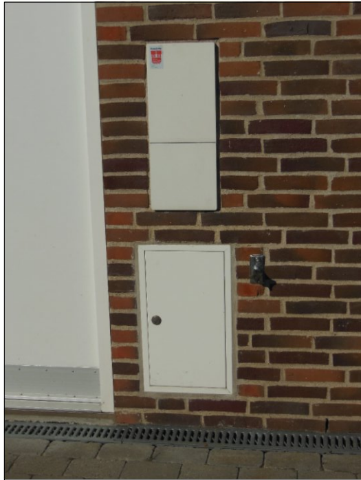
Skab indbygget i facade
